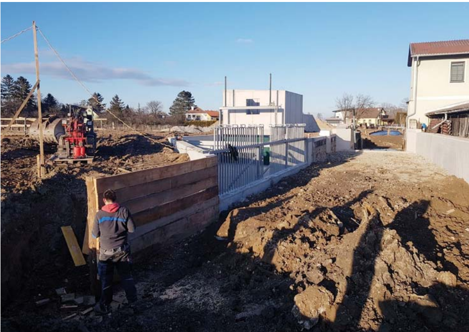
Abb. 4: Blick auf die Baustelle aus dem Oberwasser (links Krafthaus, Insel, mittig das Wehrbauwerk mit Ausnehmung für die Klappe und rechts das angrenzende Privathaus)
