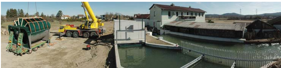
Abb. 8: Panorama-Ansicht der Anlieferung (Wasserkraftschnecke, Kran, Kraftwerk mit Zulauf und Grobrechen, Kehrbach sowie der Anlieger)
