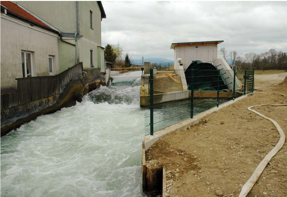
Abb. 11: Die fertige Anlage mit offener Wehrklappe vor dem Einschalten
